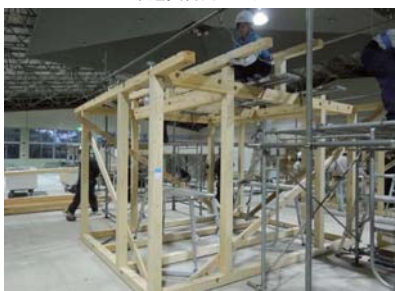
木造実習用ユニット
